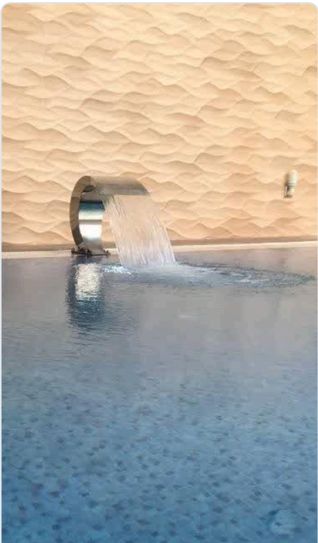
Cascada Cobra en funcionamiento
